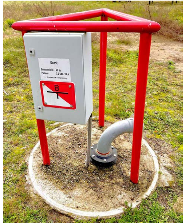
Abbildung 14: Kopfstation eines Tiefbrunnens bei Quast, Lübtheener Heide
